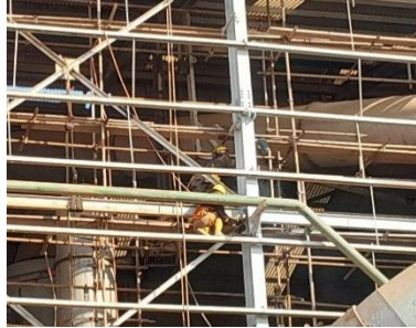
Gambar 2. Pekerja Lupa Mengaitkan Full Body Harness Double Lanyard ke Scaffolding (Sumber: Dokumentasi Lapangan, 2026)
