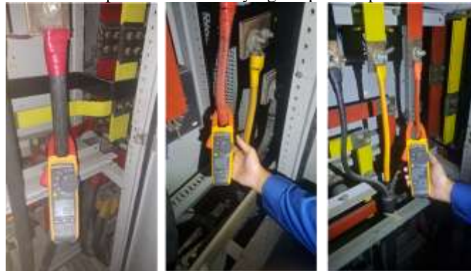
Gambar 3. Pengukuran aktual arus pada panel MCC, PDCE, dan AOP
